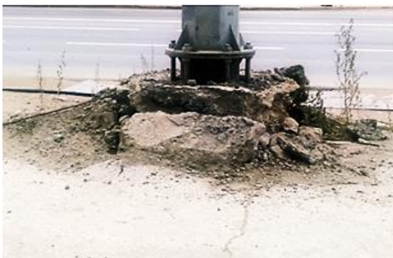
Рис. 1. Морозное пучение опоры электросети
