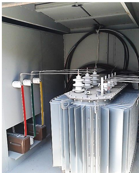
Рис. 1. Входящие в трансформатор фазы «А», «В», «С» с напряжением 10000 В
