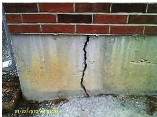
Рис. 2. Пример фундамента, претерпевшего чрезмерные деформации
