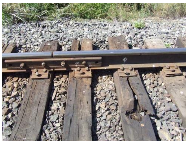
Рис. 1. Сгнившая деревянная шпала
