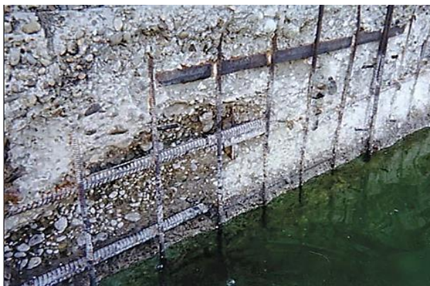
Рис. 2. Пример коррозии цементного камня
