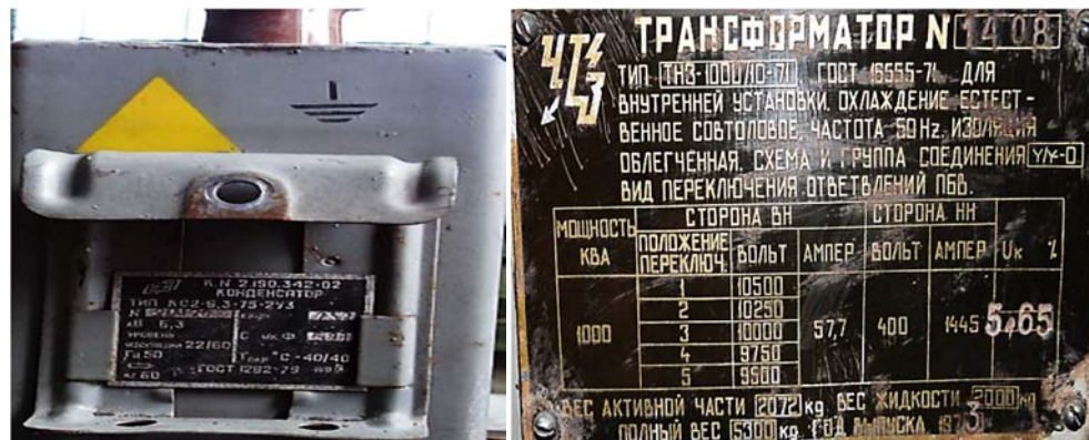
Рис. 1. Конденсаторы и трансформаторы, заполненные ПХД на территории Казахстана
