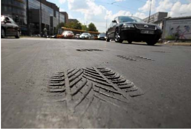
Рис. 1. Разрушение асфальтобетона при воздействии высоких температур
