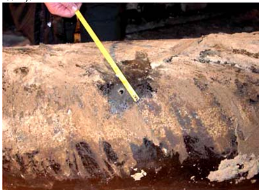
Рис. 1. Внешний вид участка трубопровода, который поражен коррозией сероокисляющих бактерий
