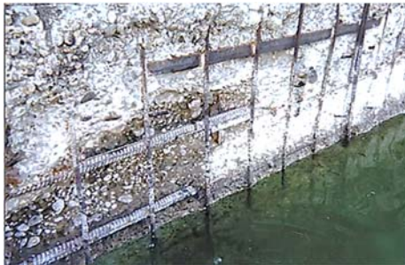
Рис. 2. Пример коррозии цементного камня
